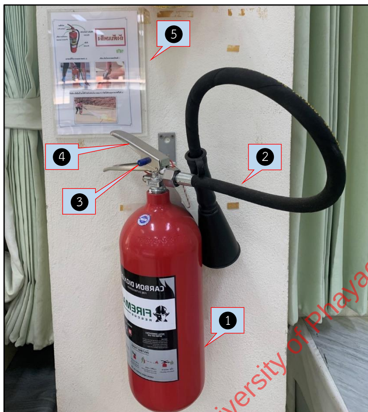
ภาพที่ 4.5 แสดงรูปภาพถังดับเพลิงและจุดติดตั้ง ที่มา: จำนงค์ เสาวลักษณ์เมฆา. (2569)
